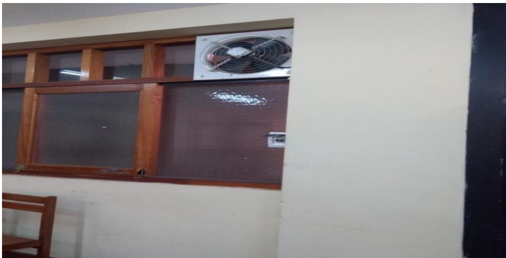
Figura 15 Talleres con escasa ventilación
