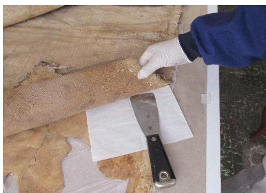
Figura 63: Detalle del desprendimiento del soporte auxiliar.
