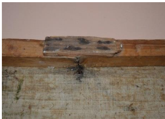
Figura 39: Se aprecia roturas intencionales en el soporte auxiliar.
