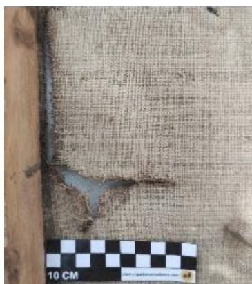
Figura 11. Detalle Rotura en el elemento 3 del soporte.
