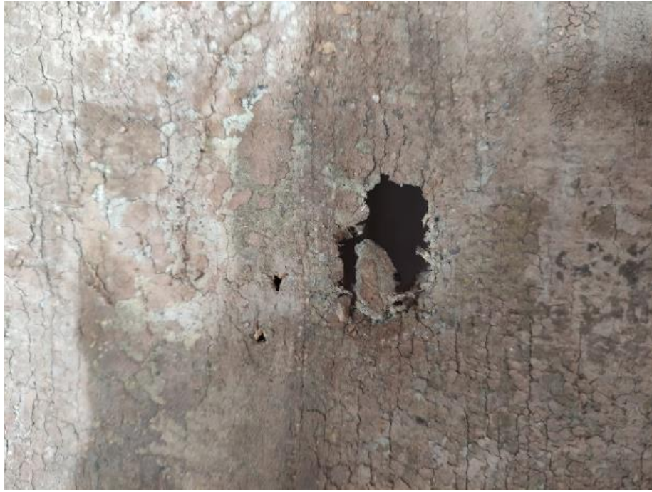
Figura G5. Detalle. Pérdida de soporte textil.
