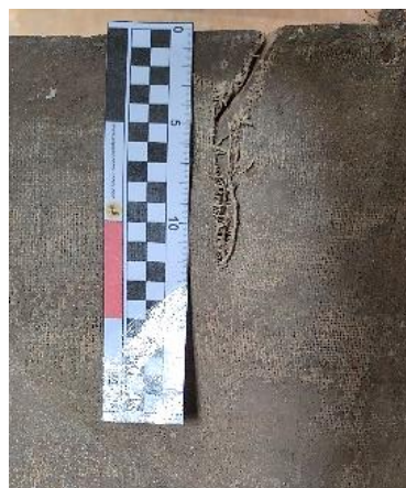
Figura 10. Detalle Roturas en el elemento 4 del soporte.
