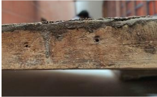
Figura 22. Detalle Perforaciones en el bastidor.
