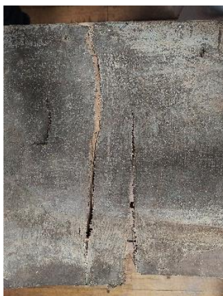
Figura 9. Detalle Rotura en el elemento 4 del soporte.
