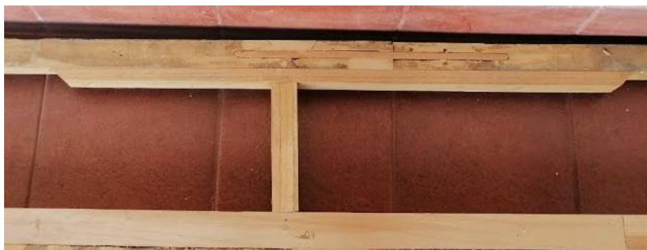
Figura 97. Refuerzo de madera en el cabezal superior.
