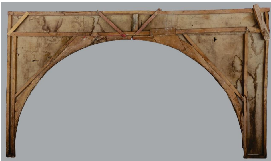
Figura B1. Estado del bastidor de la unidad de investigación.
