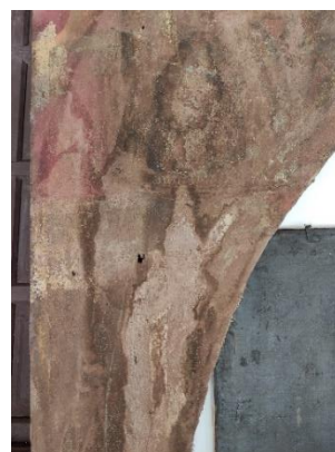
Figura 14: Detalle Manchas de humedad en el elemento 5.
