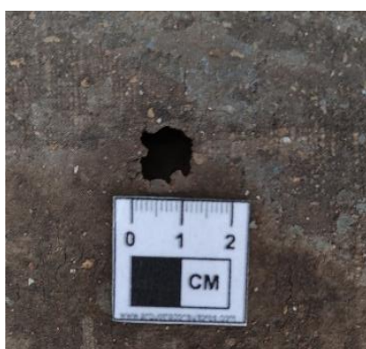
Figura 13. Detalle Pérdida de soporte en elemento 3.
