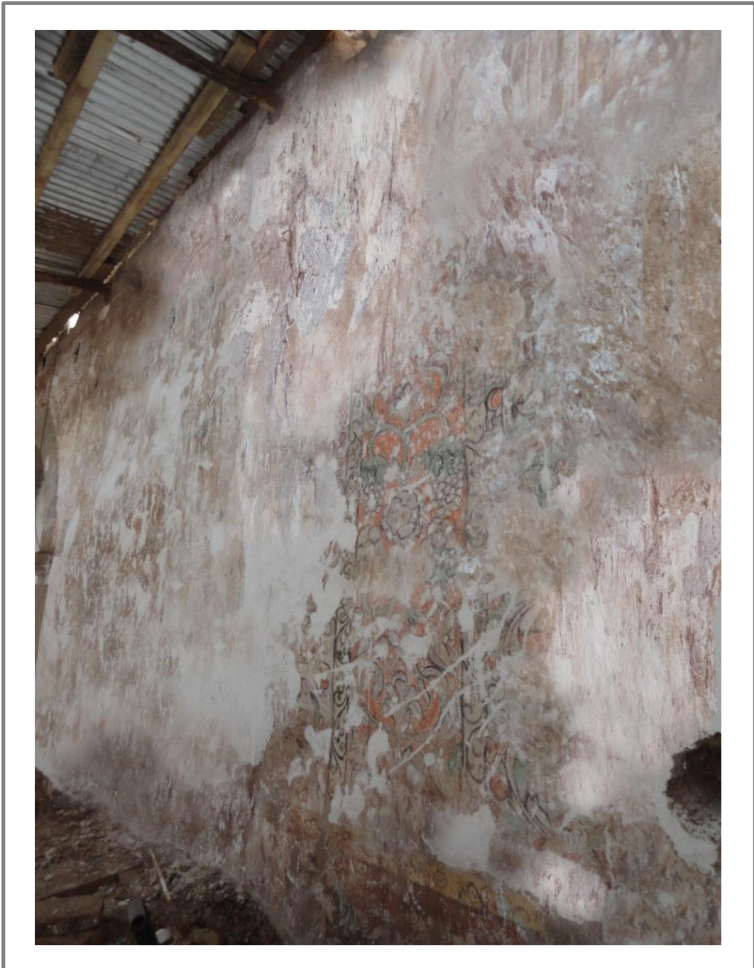
Figura 70: Estado inicial de la pintura mural Nota: Registro propio
